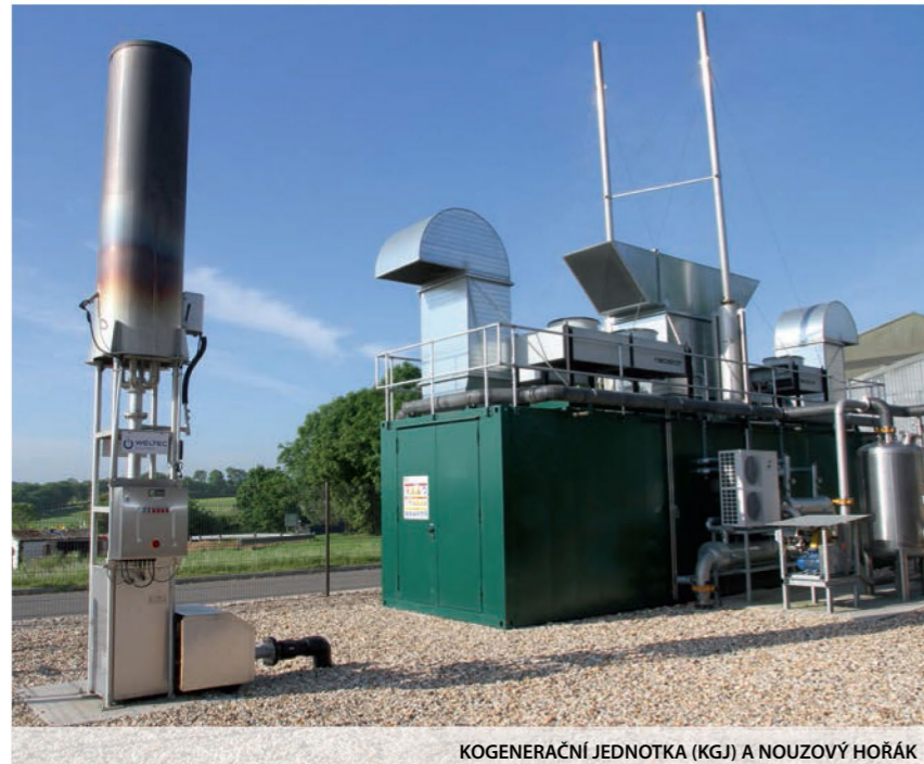
KOGENERAČNÍ JEDNOTKA (KGJ) A NOUZOVÝ HOŘÁK
