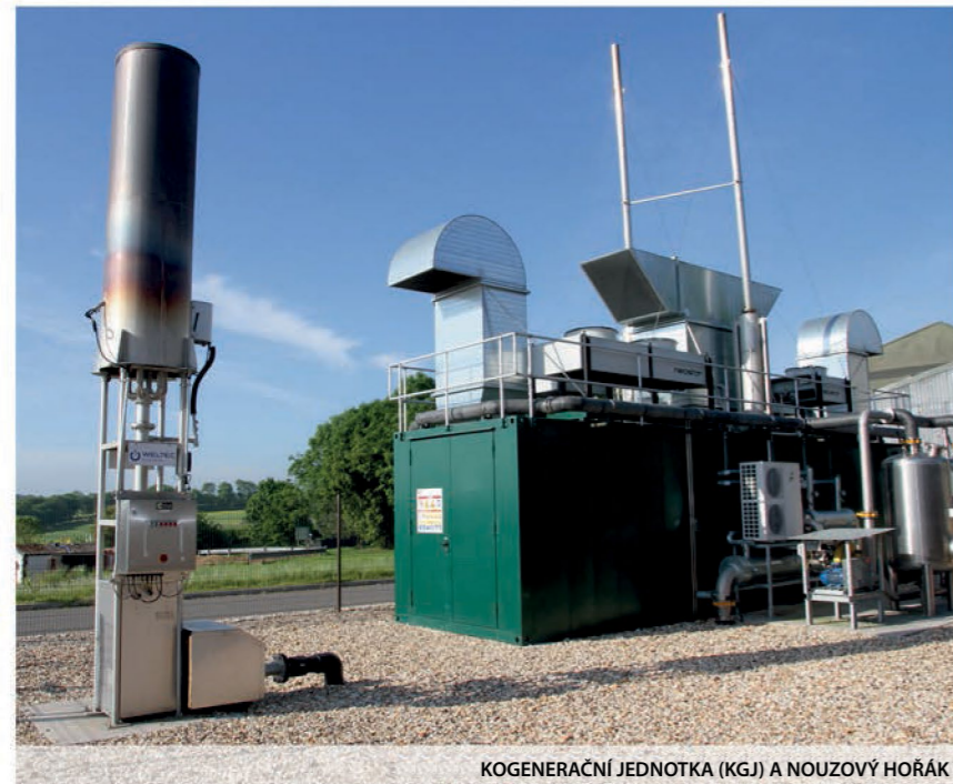
KOGENERACNÍ JEDNOTKA (KGJ) A NOUZOVÝ HOŘÁK
